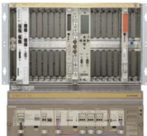
Eine Teilmodernisierung ist die intelligentere und kostengünstigere Lösung Bilder: ABC IT
